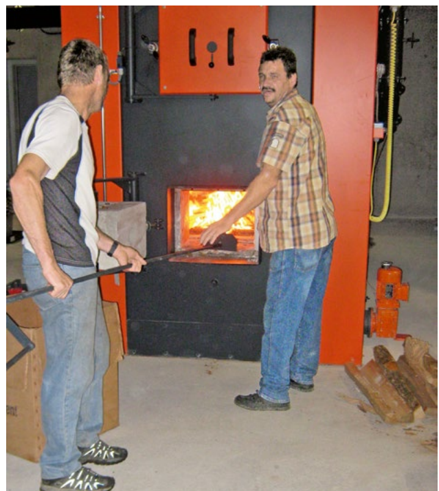
Erste Anfeuerung und anschliessender Testbetrieb der Anlage durch Wendi Kiser und Edi von Wyl, 26. August 2009
